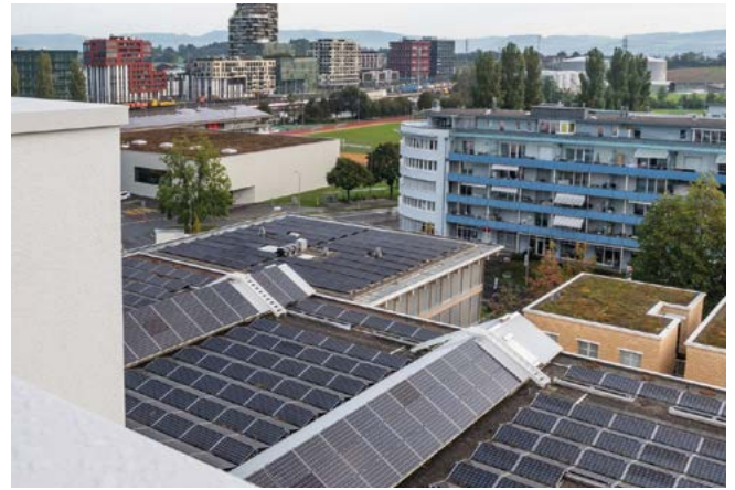
Abb. 4. Photovoltaikanlage auf dem Dach einer Turnhalle in Risch, gebaut und betrieben durch eine Energiegenossenschaft. © Rischer Energie Genossenschaft
